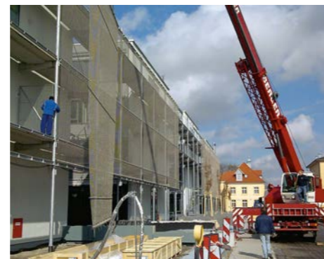
▲ Einfache Installation: Ein Blick auf und hinter die Fassade zeigt die flexible Installation
